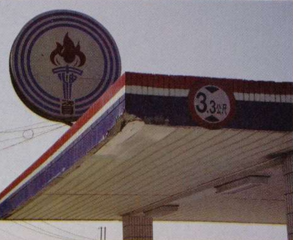
北竿加油站屋簷多次被大車撞及破角。
