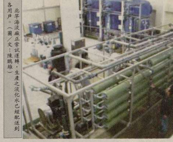
北竿海淡廠正常運轉，生產之淡化水已經配送到各用戶。(圖/文：陳曉雄)
