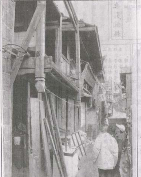
東引鄉傳統民居建築已不多見，其中東引村三六、三十七號連棟古厝，因年久失修，嚴重毀損，公所將先拆除。
