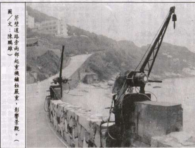
芹壁道路旁兩部起重機鋪蝕嚴重，影響景觀。
