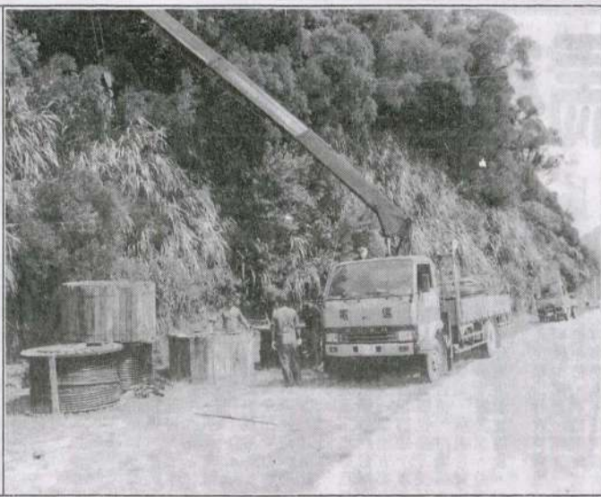
中華電信進行北竿全島地下化線路抽換工程。(圖/文：陳曉輝)
