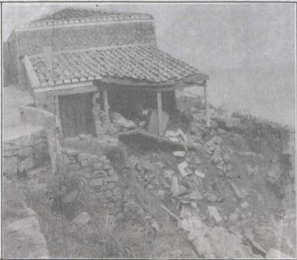
芹壁一期整建古厝遭大雨沖刷而遭成部份坍塌。(圖/文：陳鴻雄)
