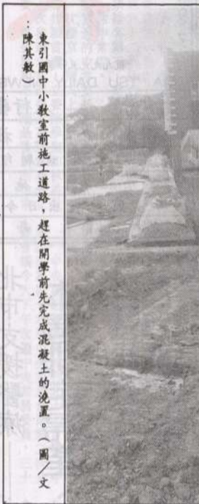
東引國中小教室前施工道路，趕在開學前完成混凝土的澆置。
