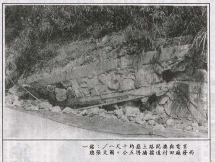
西莒發電廠後田澳村土路崩塌五十公尺，目前該路段已封鎖，交通中斷。
