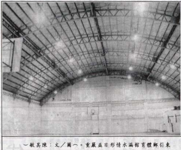
東引鄉體育館漏水情形日益嚴重。圖/文：其其
