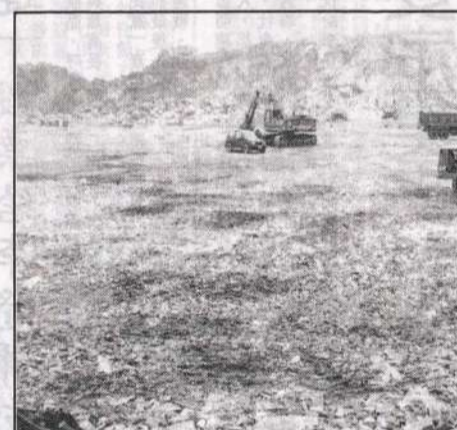
圖為南竿機場二標工程，目前進度達百分之八，承商正全力趕上落後工程。
