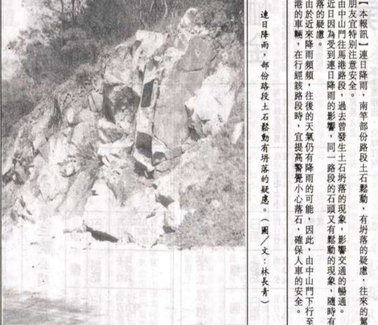
連日降雨，南竿部分路段出現土石崩落現象，提醒駕駛者注意安全。
