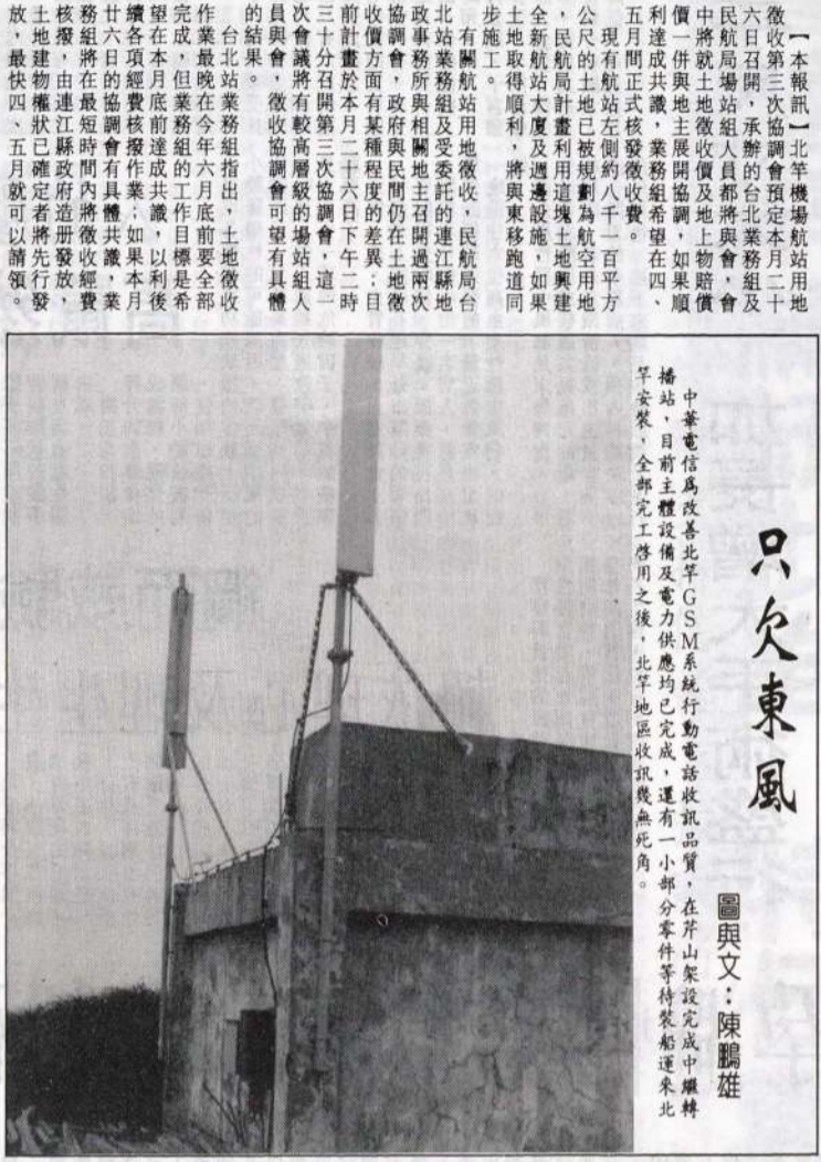
中華電信改善北竿 GSM 系統行動電話訊品質，在岸山架架完成中繼機房，目前主體設備及電力供應均已完成，連一小部分零件待裝運來北竿安裝，全部完工後，北竿地區收訊無死角。
