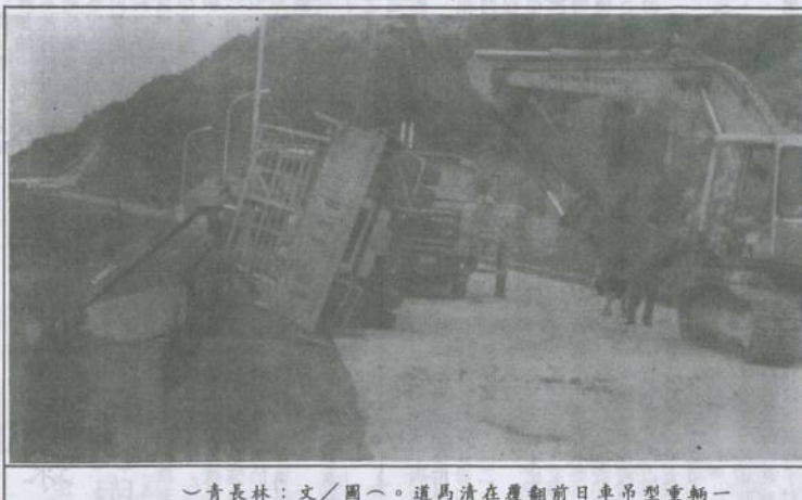
一輛重型的吊車在日前翻覆於清馬道。
