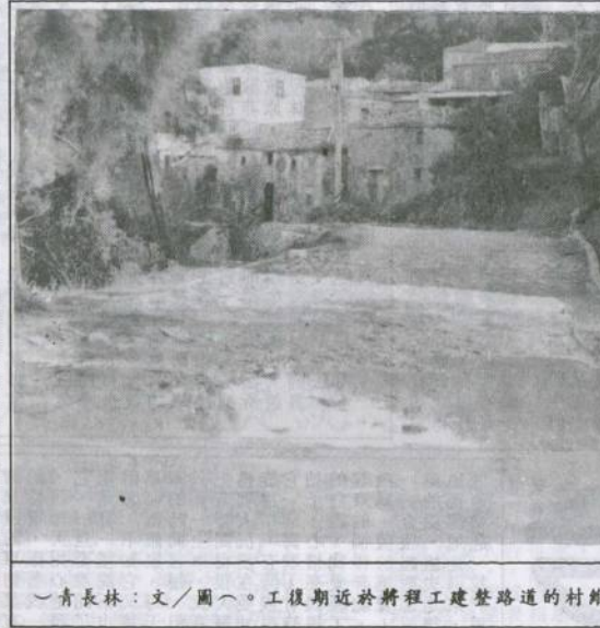
連江山莊至四維村路段近於工程復工後將進行道路修整。(圖/文：林長青)
