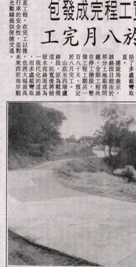
連江至西靖路段拓寬工程。圖為連江至西靖路段拓寬工程。圖為連江至西靖路段拓寬工程。
