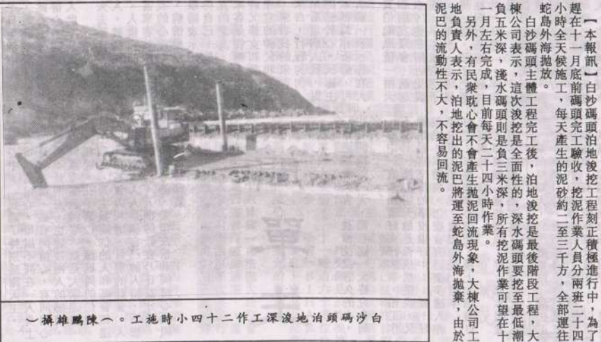
白沙碼頭地地挖泥工程積極進行，工人馬不停蹄，預計十一月月底前完成。
