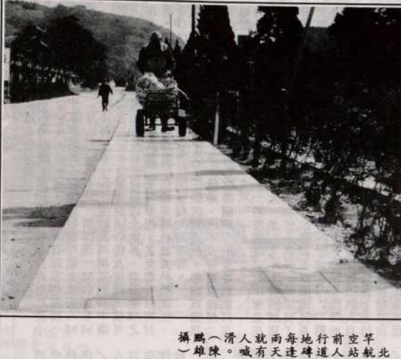
北竿航空站前人行道因地面濕滑，造成多人摔傷。
