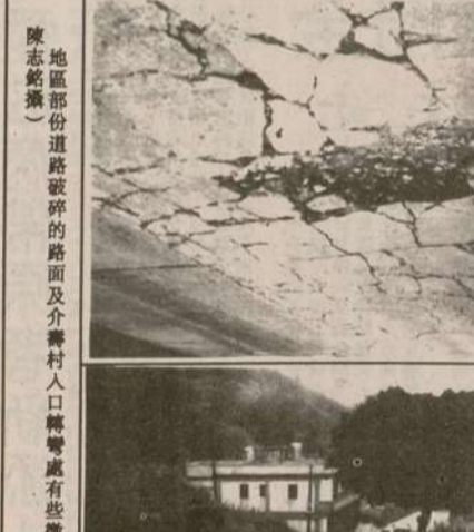
地區部份道路破碎的路面及介壽村人口稠密處有些高低差的路段。(陳志銘攝)
