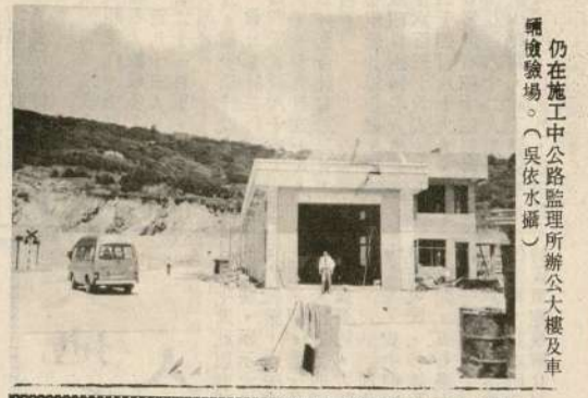
仍在施工中公路監理所辦公大樓及車輛檢驗場。(吳依水攝)
