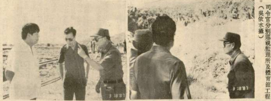
司令官分別視察體育館工程及各項工程之進展。(吳依水攝)
