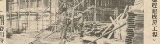
地區用電量大增，添購機組已刻不容緩。
