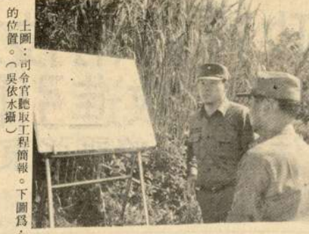
上圖：司令官親臨工程現場。下圖：司令官在工程現場與工人交談。
