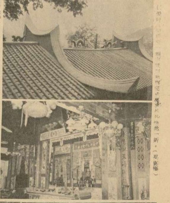
仁愛村「天后宮」廟宇，因年久失修，屋頂腐朽，牆壁剝落，經該村耆老發起，自動籌款，進行整修。
