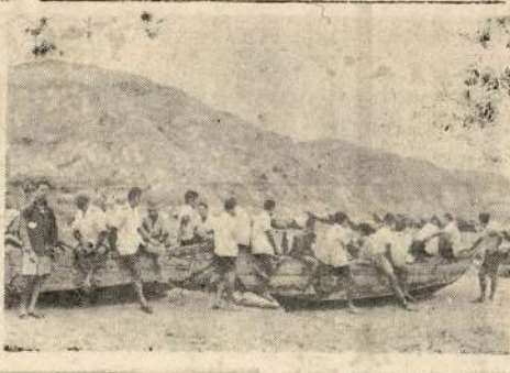
圖為連江縣政府建設委員會，在馬祖地區進行各項建設工作之情形。
